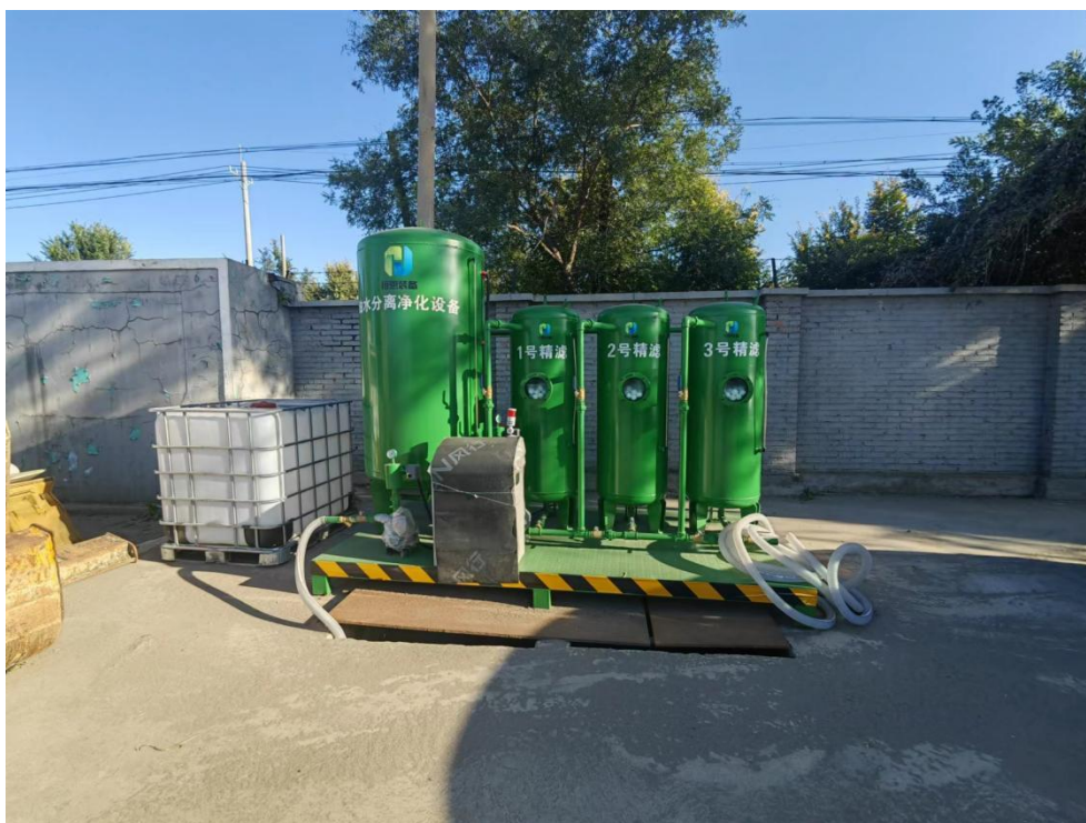
污水净化设备
